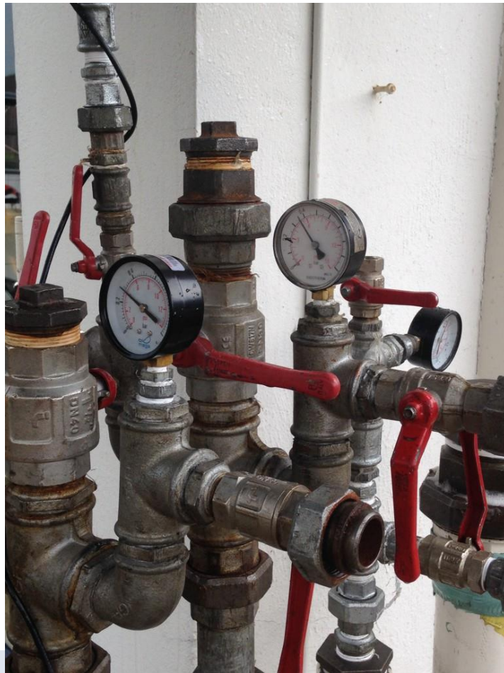
Foto 15: Op dichtheid te beproeven installatie.
